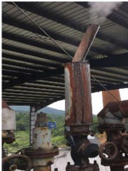
改造前余热锅炉蒸汽排口
