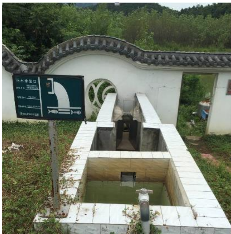
改造后项目废水总排口现场照片
