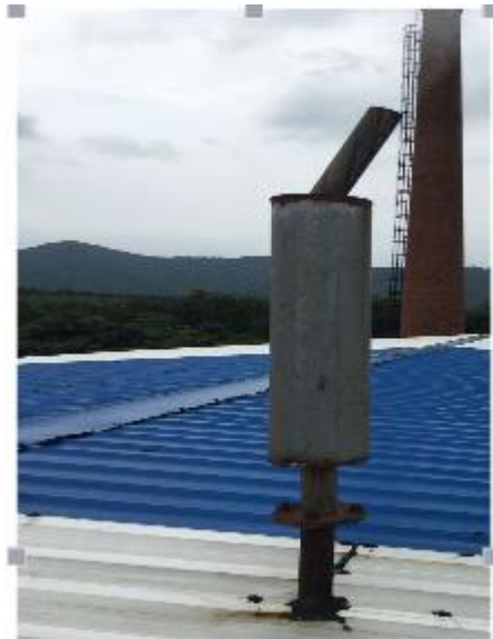
改造后余热锅炉蒸汽排口
